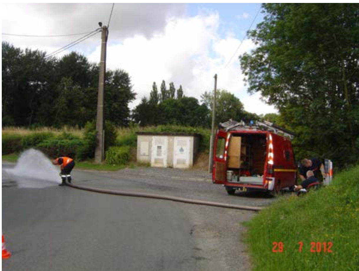
29 juillet 2012. Une fuite a été détectée. La réparation a été effectuée par la Saur.
